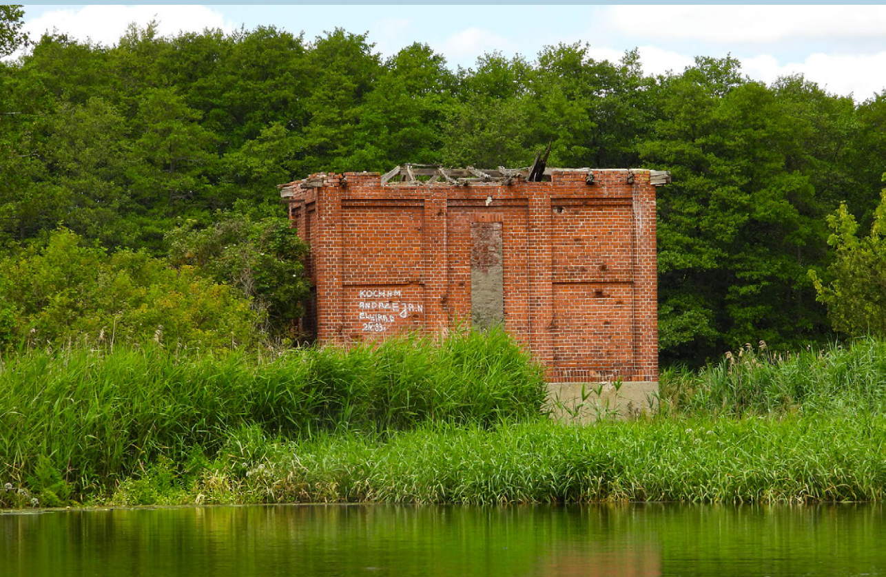
Fot. 8.9. Przepompownia Moczyły. Obecnie nieczynna, kiedyś służyła do osuszania Międzyodrza (zasoby Zespołu Parków Krajobrazowych Województwa Zachodniopomorskiego)
